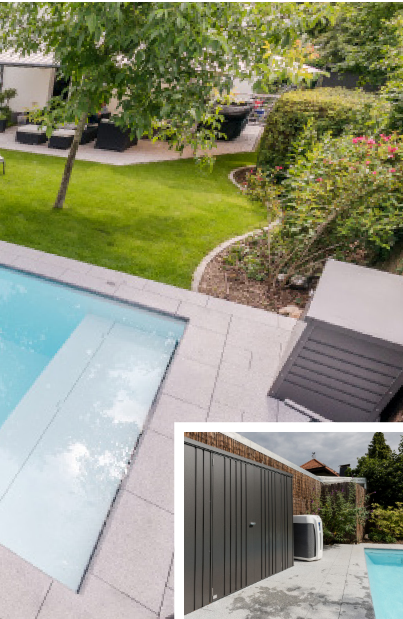
Die Schwimmbad- technik wurde in einem kleinen Häu- schen neben dem Pool integriert. Rechts daneben befindet sich die Wärmepumpe.
